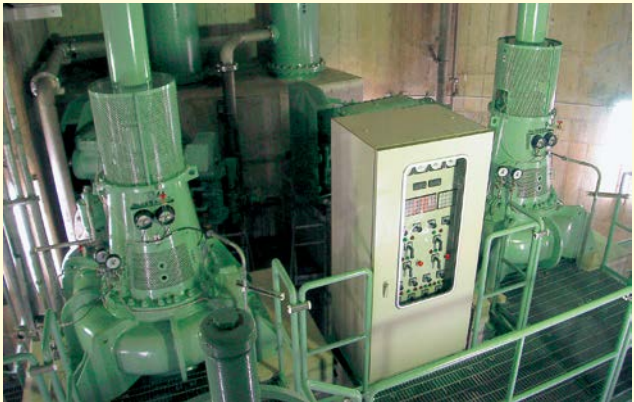
善福寺川取水施設・主排水ポンプ
